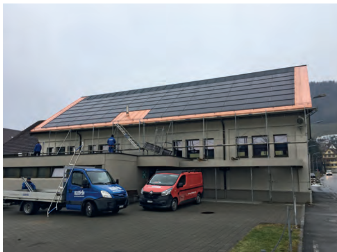
Neue Photovoltaikanlage auf der Freizeithalle
